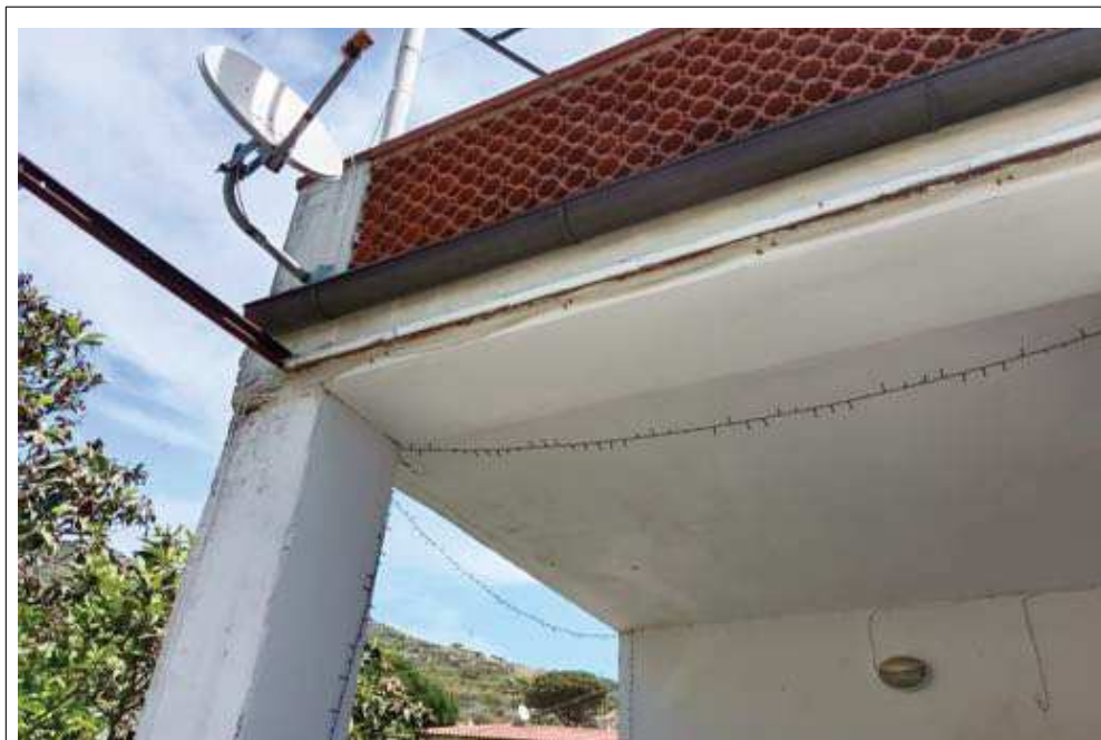
Descrizione: particolare struttura portico; si nota come sia stata realizzata una classica struttura in C.A.
