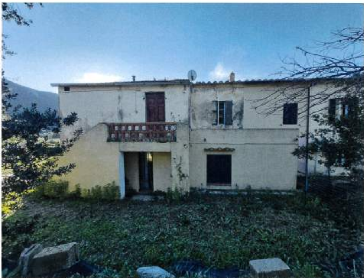
Descrizione: Prospetto Nord, presenza di superfetazioni realizzate nel corso degli anni
